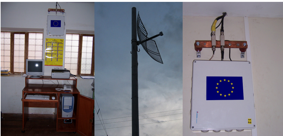
ACOPIA. De izquierda a derecha: Estación de cómputo y caja de equipo de telecomunicaciones, Antena de 24dBi montada en poste de 6 metros y Caja de equipo de telecomunicaciones.
