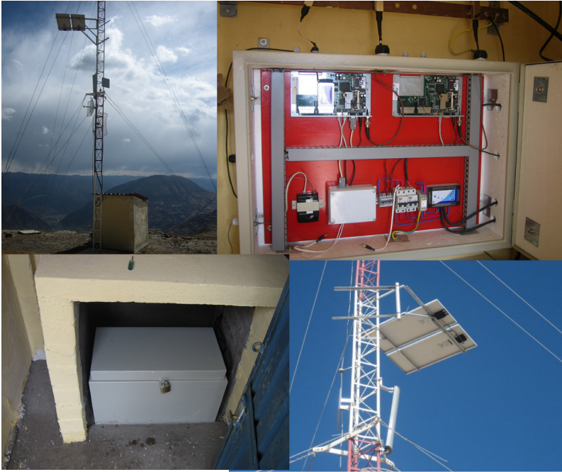
JOSJOJAHUARINA1. De izquierda a derecha y arriba abajo: Antenas y paneles solares montados en torre ventada de 12 metros, Equipos de telecomunicaciones y proteccion electrica en caja metalica, Caja metalica de bateria, Paneles solares montados en la torre ventada.
