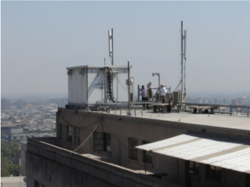
Instalaciones donde se encontraba la antena panel a la cual se enlazaba la parabólica (corresponde al lugar marcado por el círculo).
