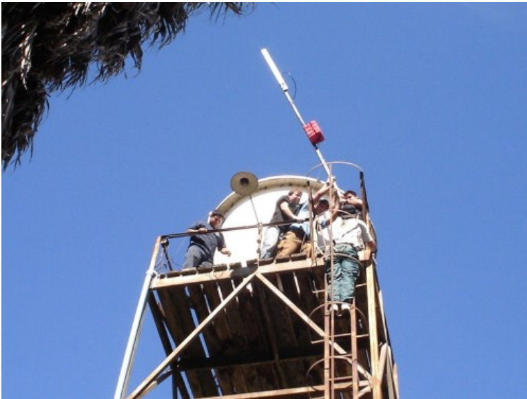
Implementación de Nodo sobre torre de agua de 20 m en la zona de Batuco, Región Metropolitana, lo cual correspondía a trabajos relacionados con enlace de telecentro Cabrati.
