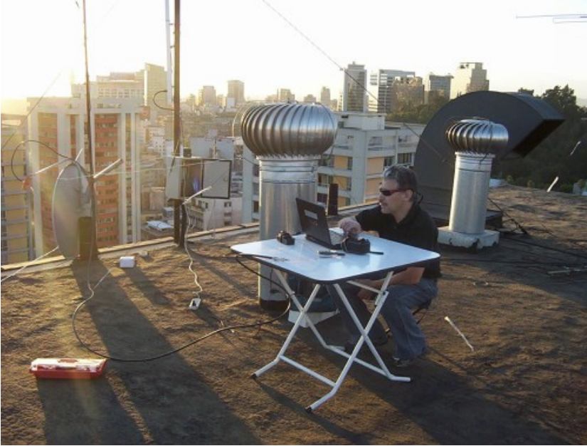
Nodo zona centro enlazado con nodo zona sur en Santiago, puede observarse antena parabólica que realiza el enlace y antena ranurada para captar clientes.
