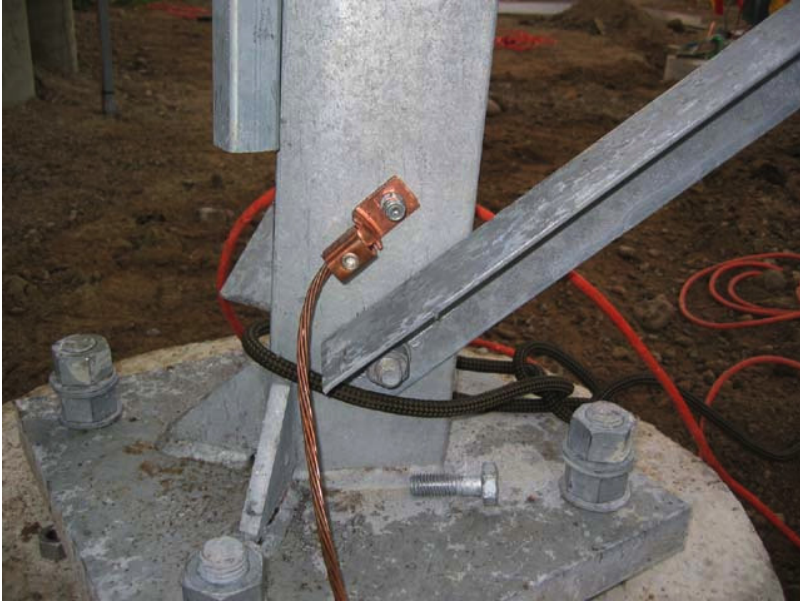
Figura 5.2: Torre con un cable de cobre grueso conectado a tierra.
