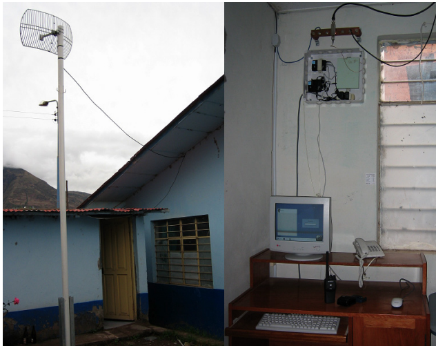
URCOS. De izquierda a derecha: Antena direcciva de 24dBi montada en poste de 6 metros, Estación de cómputo y equipo de telecomunicaciones en Urcos
