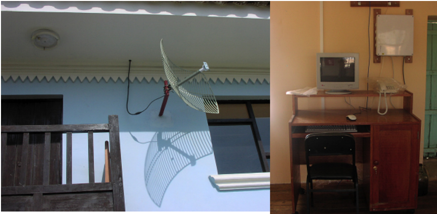
KCAURY. De izquierda a derecha: Antena direcciva de 24dBi montada en brazo mecánico y Estación de cómputo y caja de equipos de telecomunicaciones.
