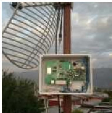
Nodo en la comuna de la Granja Santiago, enlazado a nodo Santiago Centro (10 s), se observa una antena parrilla.
