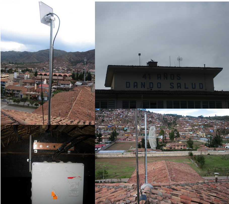
HOSPITAL CUSCO. De izquierda a derecha y arriba abajo: Antena direccional de 19dBi apuntando a la Red Sur, Antenas montadas en tejado, Caja de equipos montada en el interior del tejado y antena direccional de 24dBi apuntada al repetidor Josjojahuarina 1.
